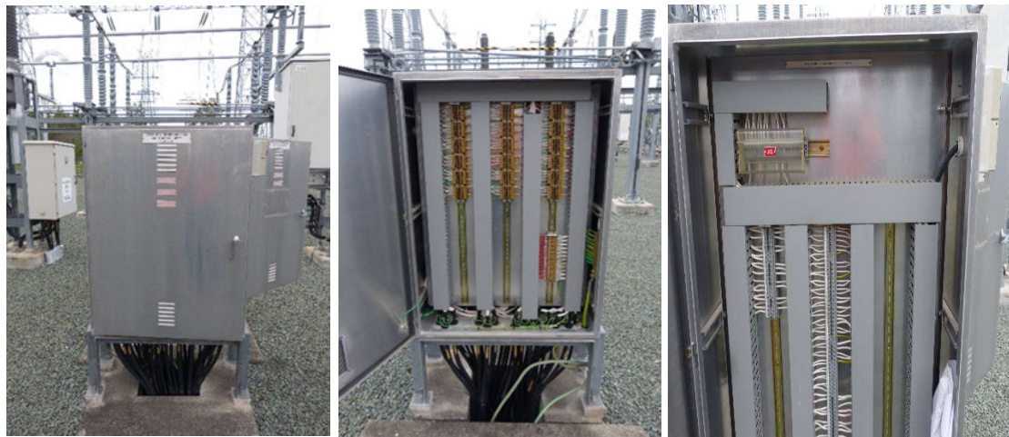
(d) =C05-A20 Bay Marshalling Kiosk
