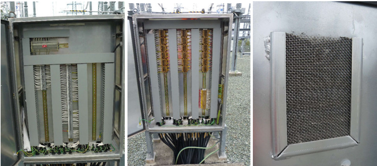
(b) =C04-A20 Bay Marshalling Kiosk
