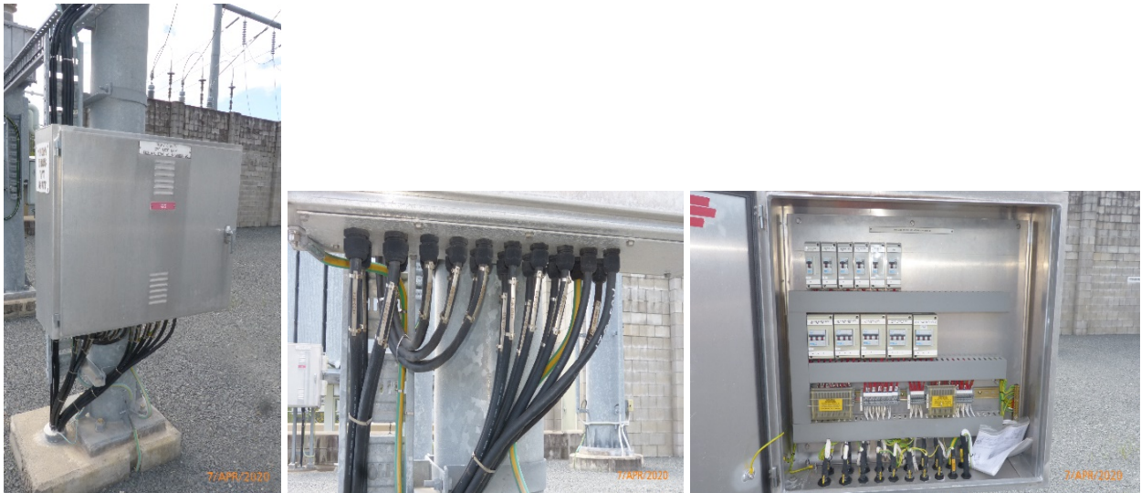
(e) 132kV Bay =D07 DC Marshalling Kiosk (+D07-A92)
