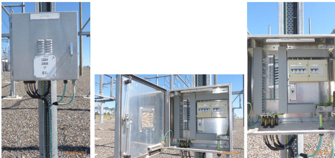
(b) 132kV - 2 Bus 8 VT Marshalling Kiosk (+KD2-A50)
