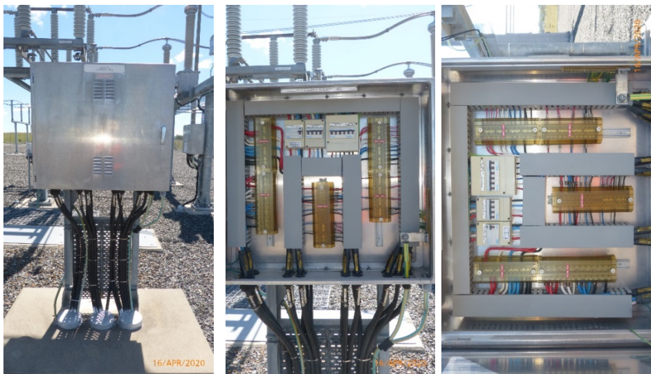
(d) 132kV Bay =D07 AC Marshalling Kiosk (+D07-A91)
