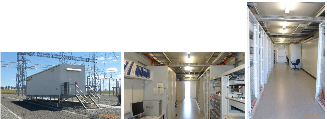
(d) 275kV Demountable Control Building +4
