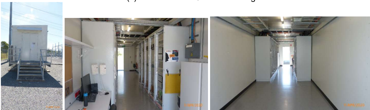
(d) Demountable Control Building +8
