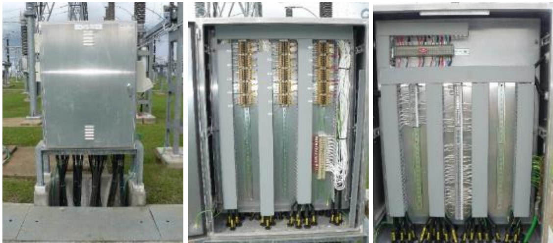
(d) =C02-A30 Bay Marshalling Kiosk
