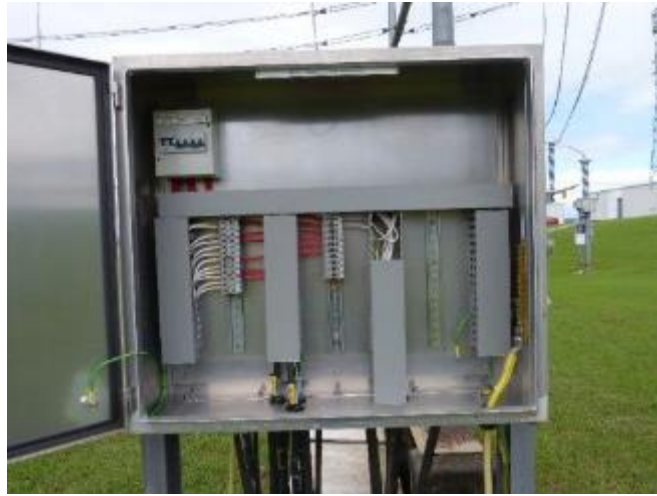
(d) =D15-A92 Bay DC Marshalling Kiosk
