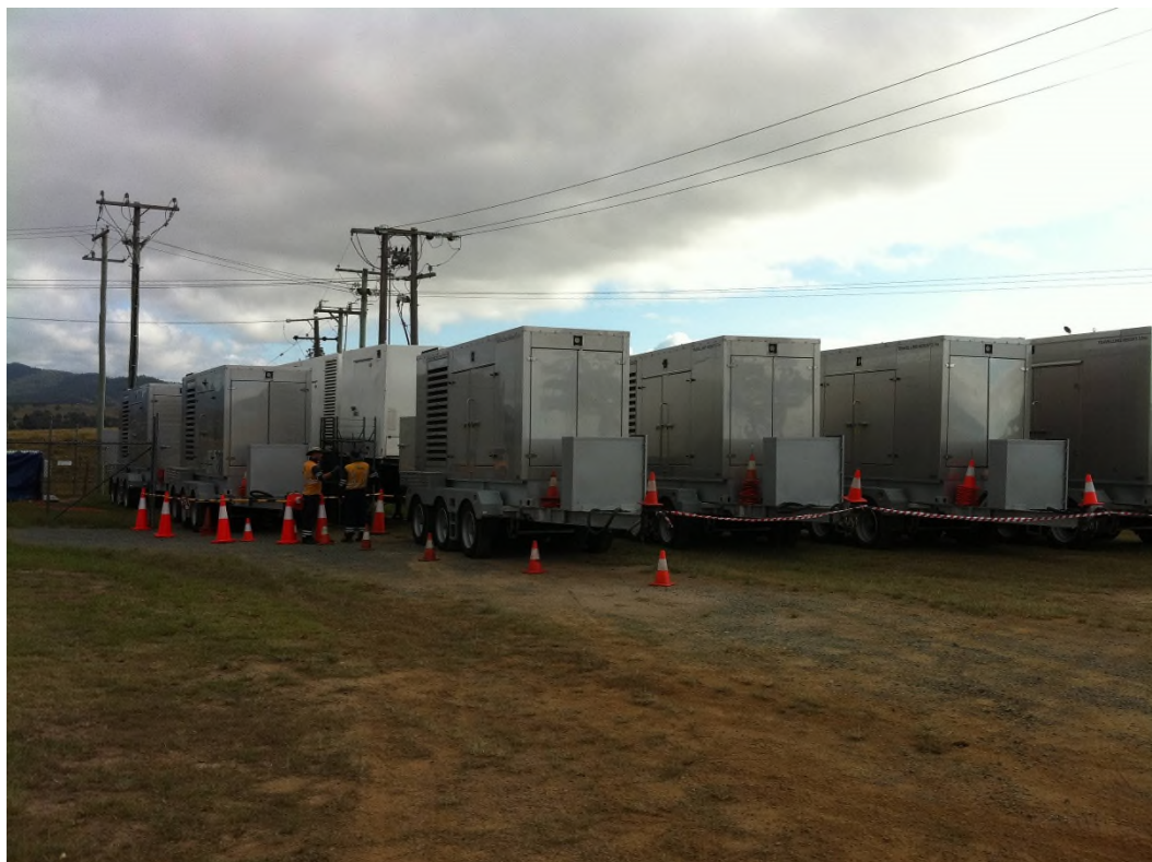
Energex' HV mobile generator
